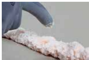
Lijmlaag barst open bij aanraking: te vroeg
